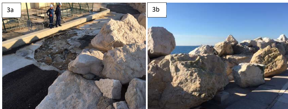
Figure 3 : Photographies des dégradations au niveau de la digue du CCG de Martigues. (3a : dégradations au niveau de la route entre la station de pompage et la digue de protection de la station de pompage. 3b : brèche au niveau de la digue de protection du plan d'eau avec enrochements tombés sur la voie de service)
